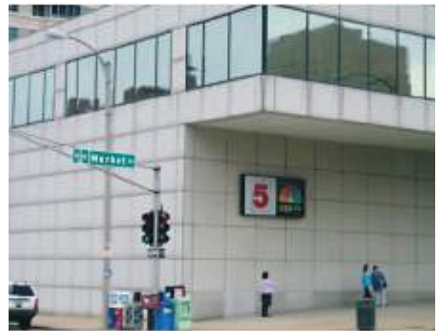
Figura 8.18. Fachada con manchamiento de junta sellada.
